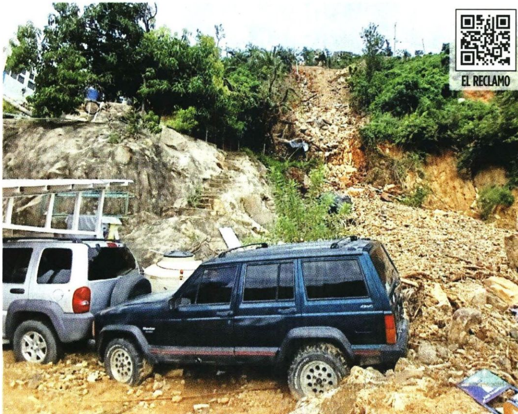
■ Una parte del muro de contención de la carretera Escénica cayó en el patio de la casa donde vive don Gustavo Romero, en Puerto Marqués.
