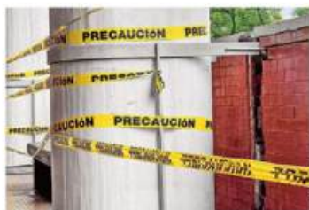
PELIGRO. Alumnos de la Facultad de Medicina en la UNAM han normalizado las medidas de precaución por un edificio afectado
