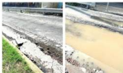
· El concreto presenta graves fracturas
