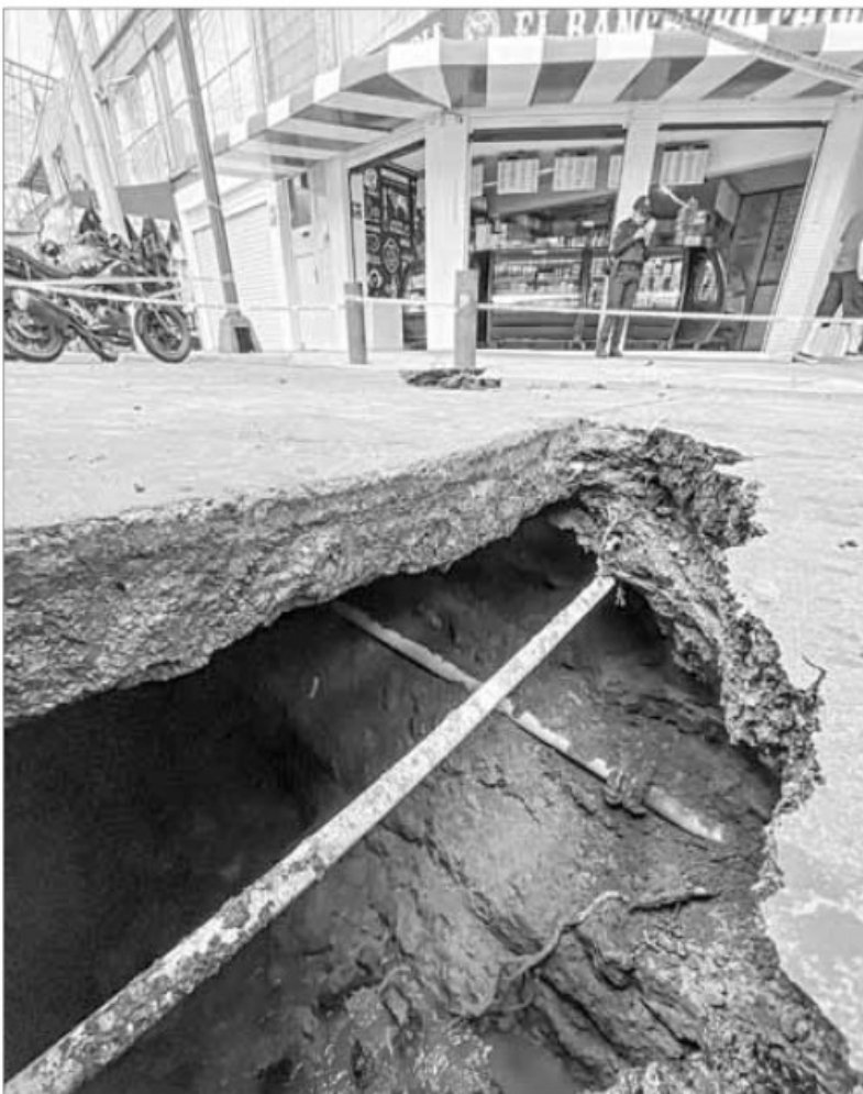
▲ La ruptura del drenaje ubicado en la calle Don Luis, en su cruce con avenida Plutarco Elías Calles, en la alcaldía Benito Juárez, provocó un
