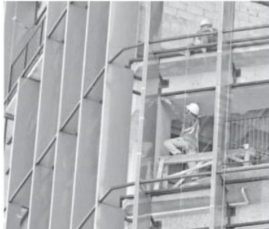
El sector de construcción se ha deteriorado
