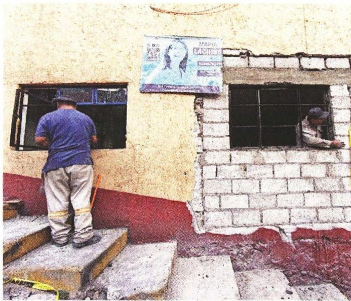
■ Así luce la fachada de la casa que resultó dañada hace una semana por el impacto de un camión que derrapó.
