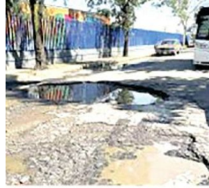
Falta reparación de calles
