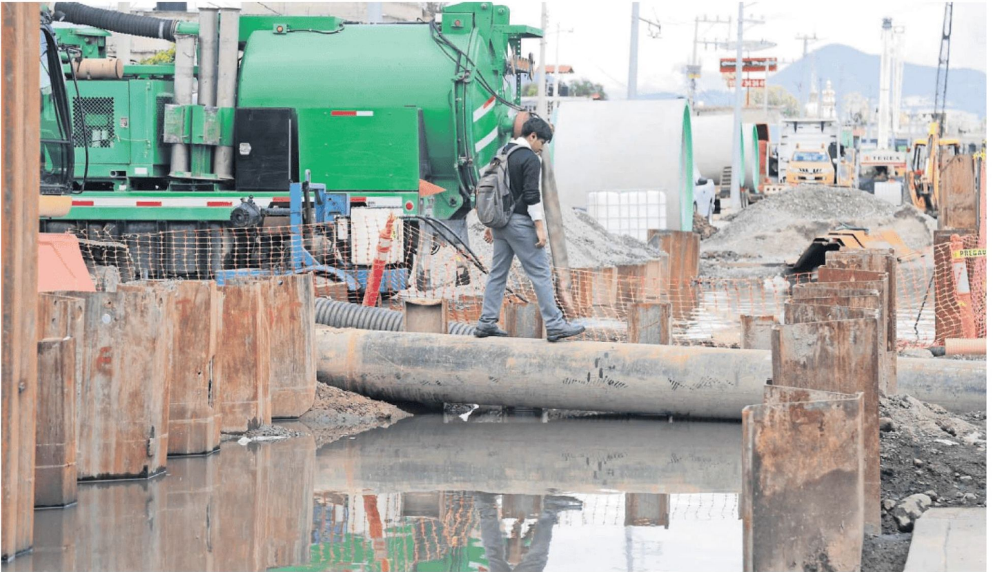
Algunos vecinos libran los encharcamientos en el área de obras del Colector Solidaridad.
