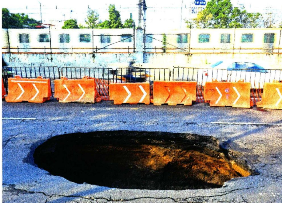
El socavón en la alcaldía Iztapalapa se abrió la tarde del 13 de agosto en los carriles centrales de la calzada, tiene 4 metros de largo, 2.5 de ancho y 4.5 de profundidad sobre la tubería de drenaje.
