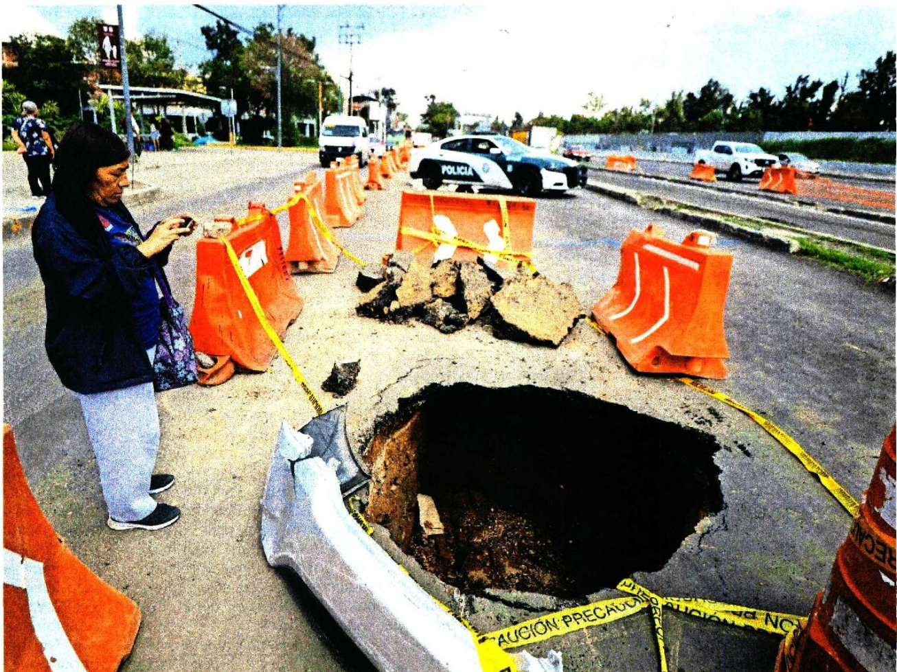
El socavón en Iztacalco está ubicado en la lateral de calzada Ignacio Zaragoza a la altura del Walmart y la calle de Agua Caliente.
