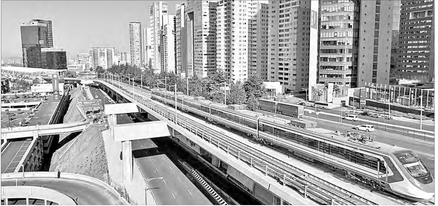
▲ Las obras del Tren Interurbano México-Toluca, bautizado El Insurgente, contará con tres estaciones en la Ciudad de México, una de las cuales conectará con la línea 1 del Metro. Foto La Jornada
