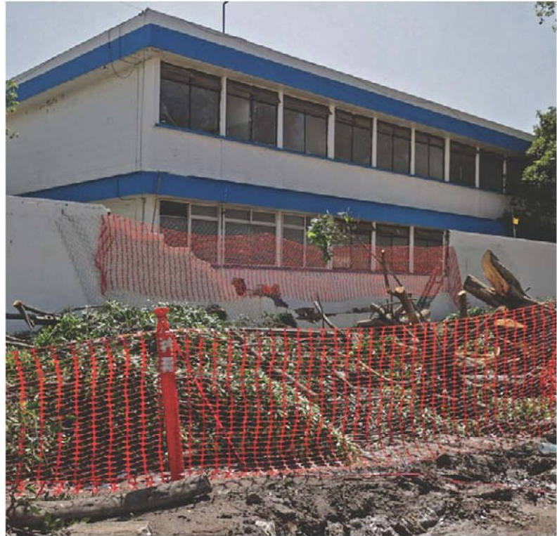
Las principales afectaciones son filtraciones en los techos, deslaves, daño en bardas e inundación en los salones. ESIMAGEN
