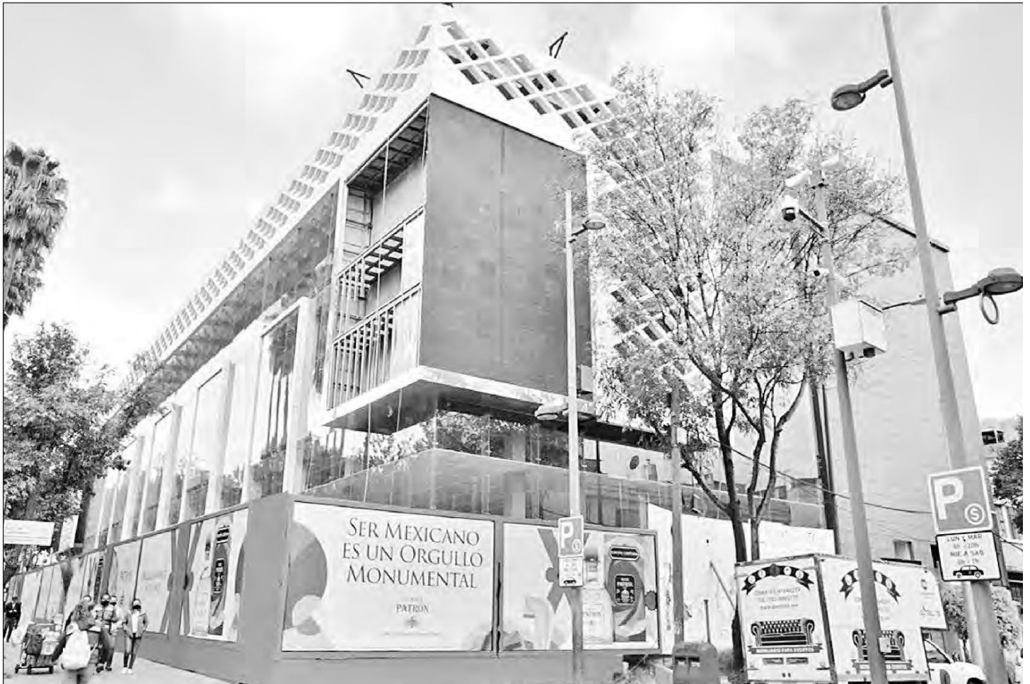
▲ Por construir un piso excedente –cuya demolición se suspendió– en Lafontaine 110, el alcalde y otros funcionarios son investigados. Las anomalías comenzaron en 2018. Foto tomada de redes sociales
