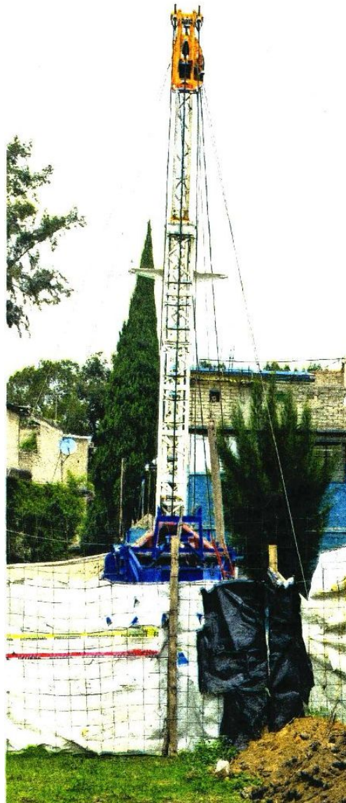
Los pozos de infiltración ayudarán a mitigar los encharcamientos por lluvias y recargar el acuífero.
