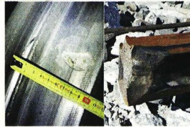
■ En España una comisión técnica detectó roturas en la soldadura.
