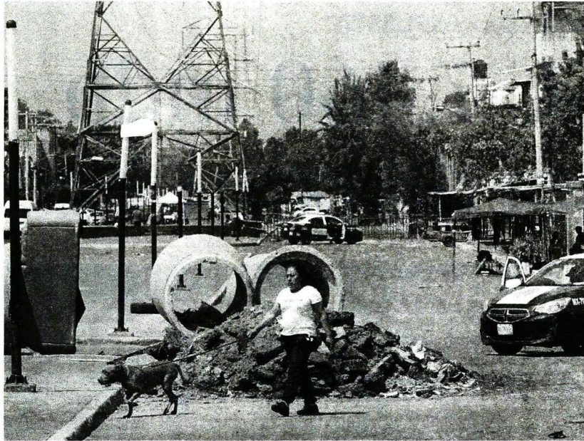
Las autoridades no permiten el paso de vehículos para evitar más socavones
