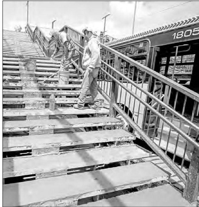
► Los trabajos de mantenimiento en el paradero de Huipulco complican el tránsito diario de los usuarios, ya que trabajadores y maquinaria obstruyen el paso en pasajes y escaleras. Foto Cristina Rodríguez
