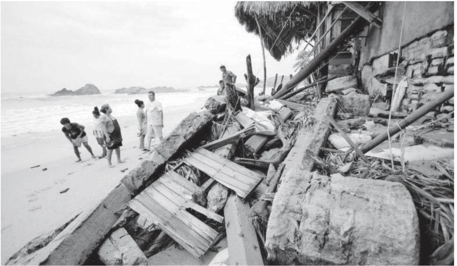
Las lluvias por Erick causaron daños en viviendas en la costa de San Agustínillo, Oaxaca
