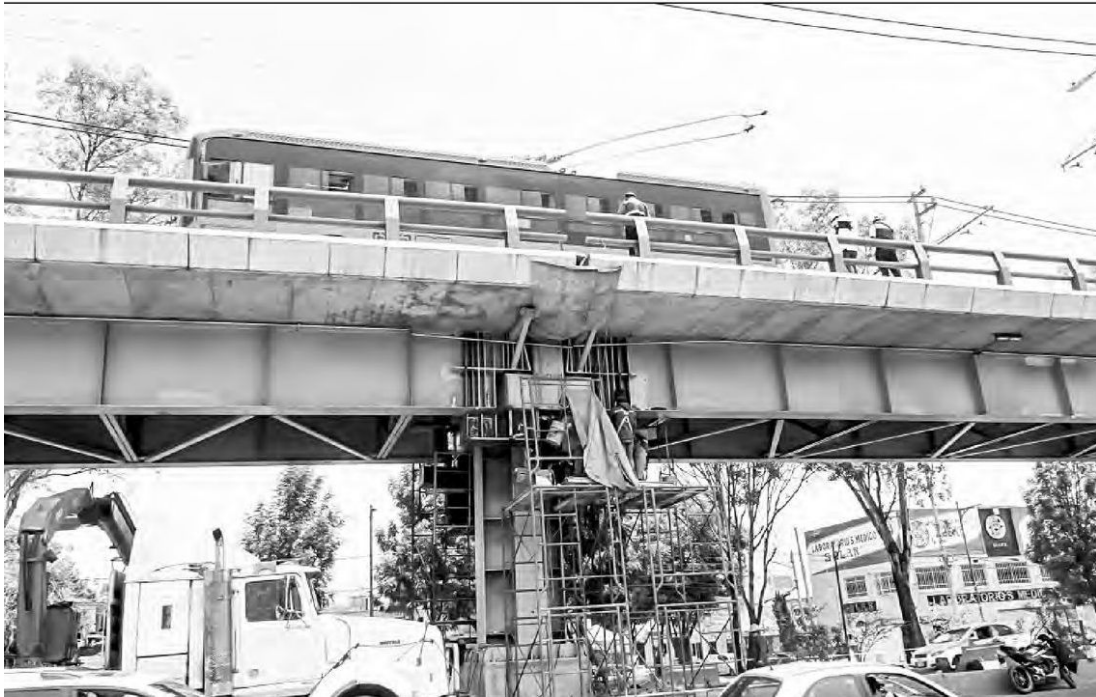
▲ Hundimientos, grietas y la separación de travesaños del Trolebús Elevado en la colonia Santa Cruz Meyehualco son consecuencias de un terreno "blando y compresible", lo que representa un suelo poco favorecedor a nivel estructural, con tendencia a la deformación, señaló la académica Claudia Rojas Serna. Foto María Luisa Severiano
