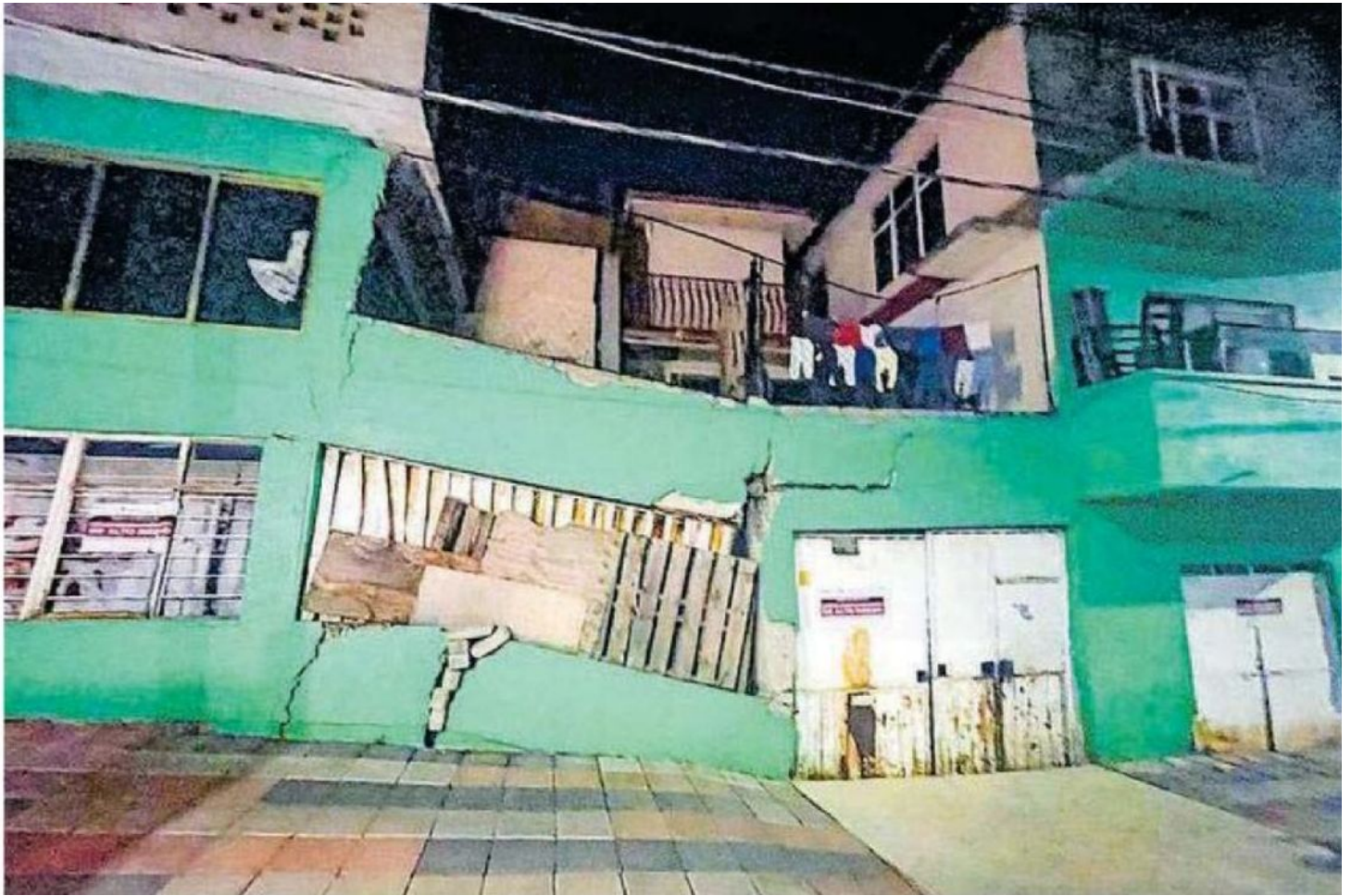
Una de las casas de alto riesgo donde se observan daños por grietas en la colonia San Sebastián Tecoloxtitla, Iztapalapa
