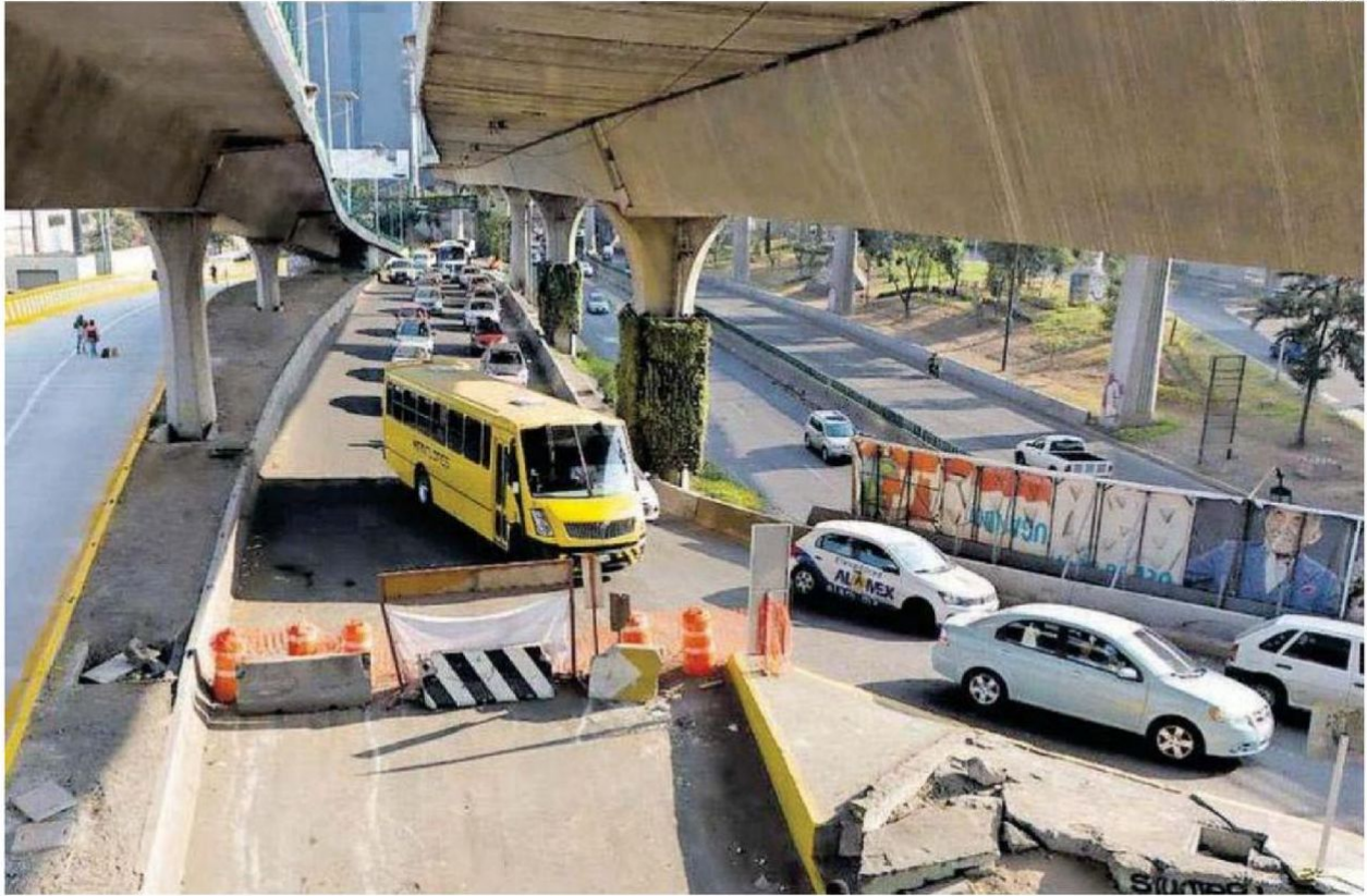
Obras inconclusas en la lateral del anillo Periférico Norte a la altura de Río San Joaquín siguen provocando tráfico
