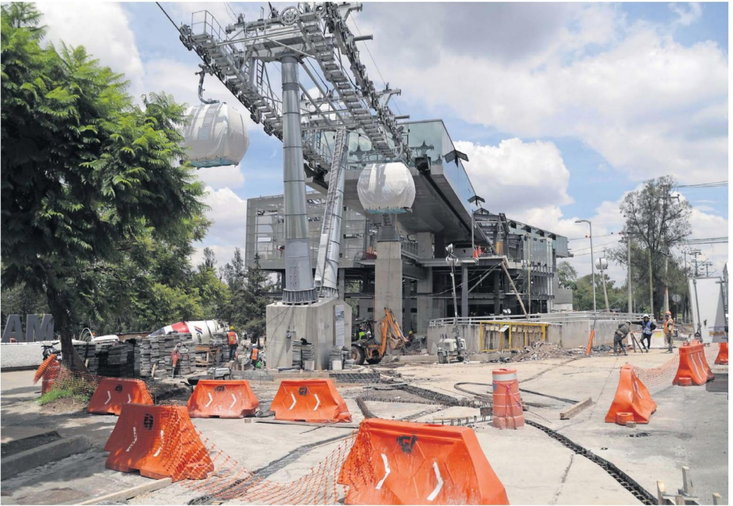
En las seis estaciones de la Línea 3 del Cablebús continúan los trabajos a marchas forzadas para entregar la obra antes de que termine septiembre.
