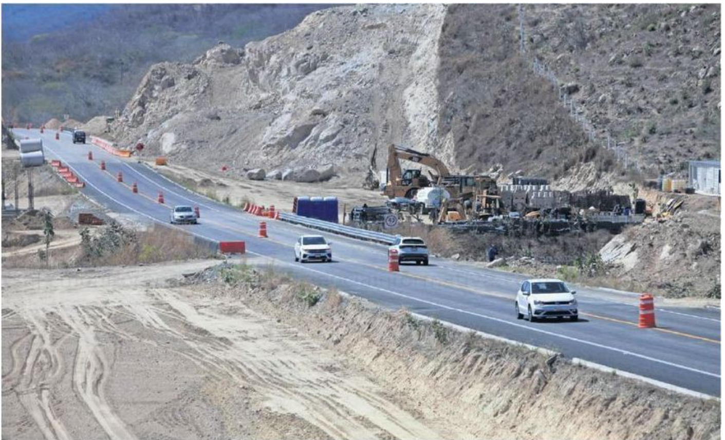
En un recorrido se pudo comprobar que la autopista Barranca Larga-Ventanilla tiene numerosos puntos en obra, se observan desvíos, así como hombres y maquinaria trabajando.
