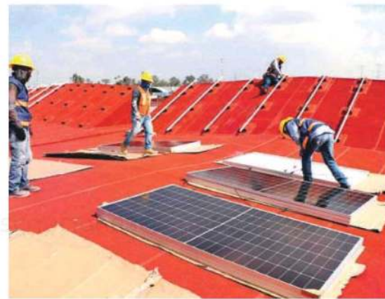
La instalación de paneles solares lleva un avance del 38 por ciento con una inversión de 26.1 millones de pesos /FOTO SEDECO
