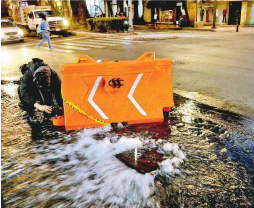
Las fugas de agua potable a veces no son atendidas con prontitud, por lo que miles de litros se van al caño /DAVID DEOLARTE
