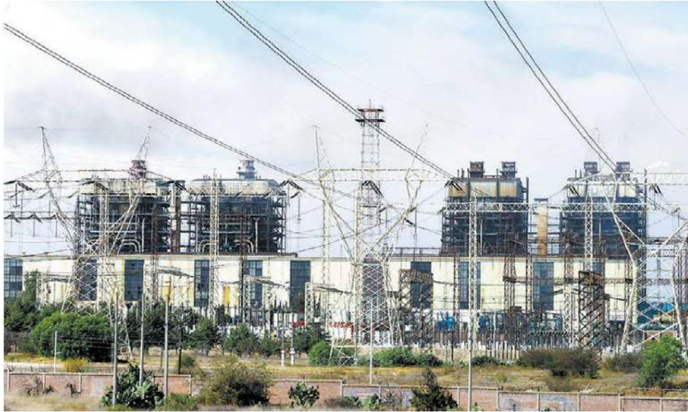
Central termoeléctrica de Tula, Hidalgo. JAVIERRÍOS
