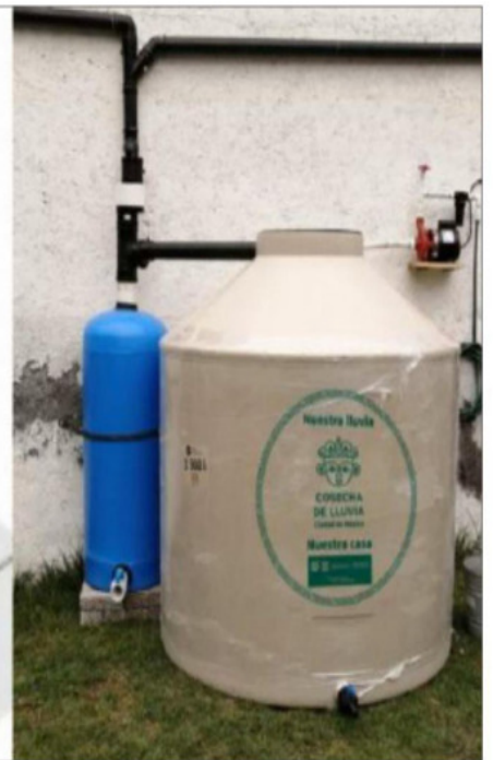
Sistema de cosecha de lluvia instalado en una vivienda en la CDMX
