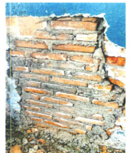
Unos hoyos han sido tapados, pero ya se observan huecos.
