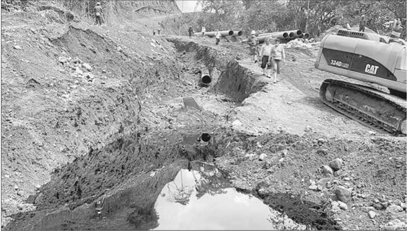
▲ Tramo donde se rompió el oleoducto de OCP en la región amazónica de Piedra Fina. Foto Afp/Ministerio de Ambiente de Ecuador
