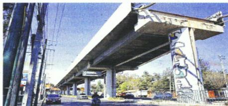
Después de las primeras auditorías, el tramo de viaducto elevado en la Línea 12 presentó fallas.
