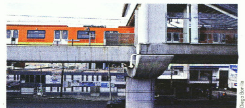
Tras el colapso en Oliveros, el Gobierno capitalino trabaja en un refuerzo completo a la estructura.
