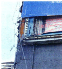
■ Los anuncios están conectados a instalaciones eléctricas irregulares.
