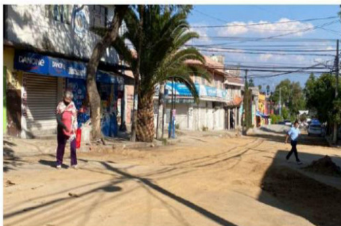
Calles de Peñón de los Baños colonia ubicada en la alcaldía Venustiano Carranza lucen sin postes de luz, sin agua potable en funcionamiento, sin pavimento y hay escombros y excavaciones en la vía pública.
