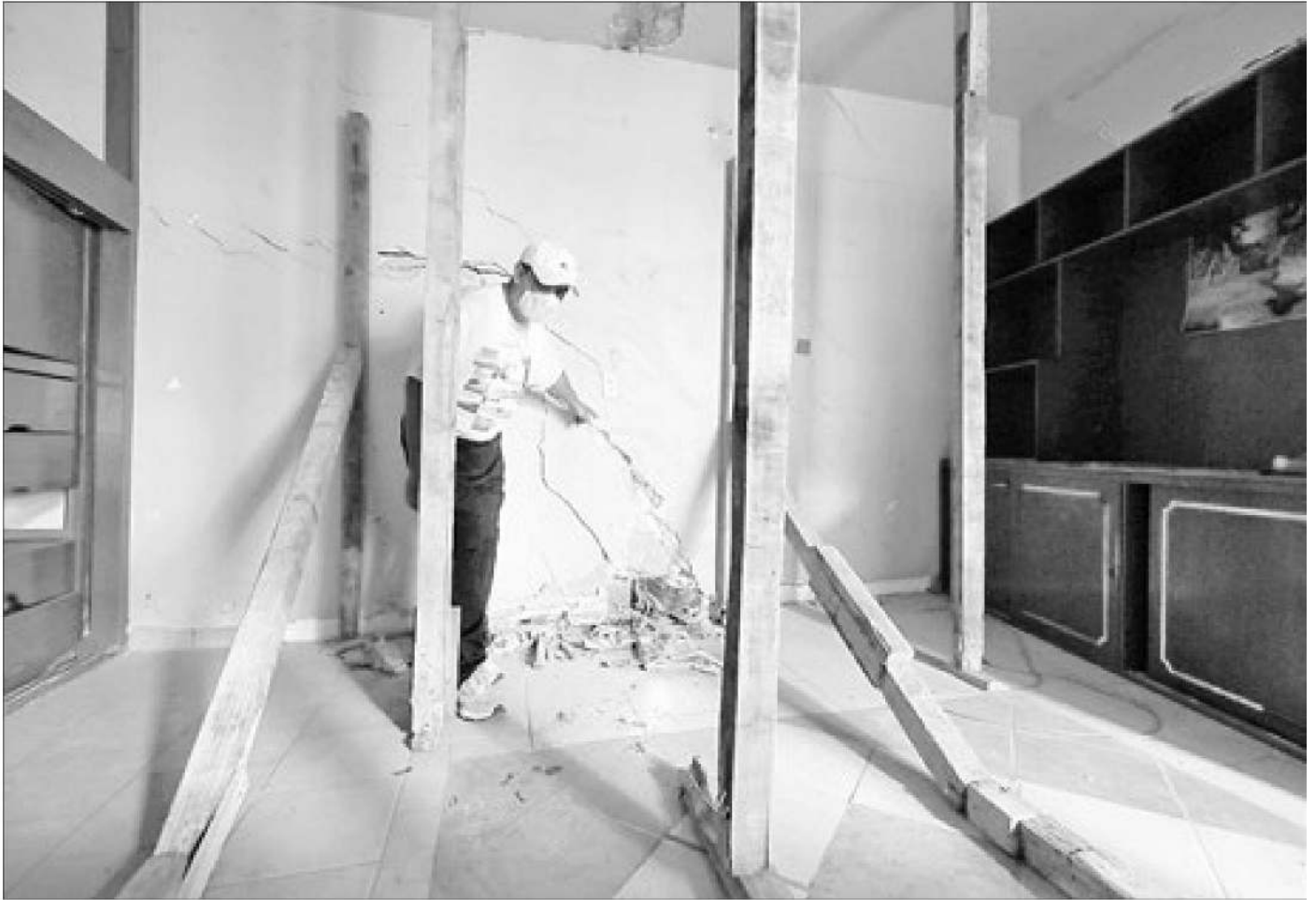
▲ La vivienda de la familia Jáuregui continúa deshabitada y en malas condiciones estructurales, tras el socavón que se formó por una fuga de agua. Foto Roberto García Ortiz
