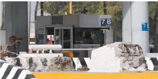
El accidente en que un tráiler impactó contra vehículos en la caseta de cobro de San Marcos ya cumplió 50 días.
