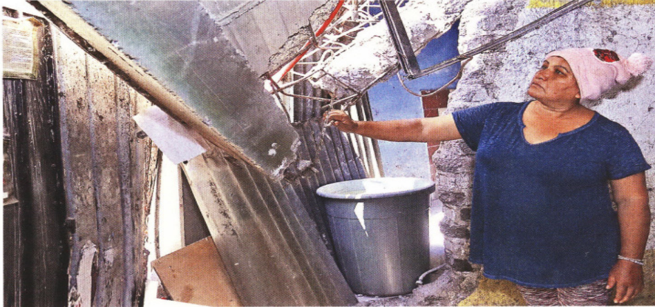
DE VUELTA. Maura muestra los daños que sufrió su casa luego del derrumbe en el Cerro del Chiquihuite.
