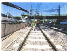
Se prevé modernizar el sistema eléctrico de la catenaria del tren.
