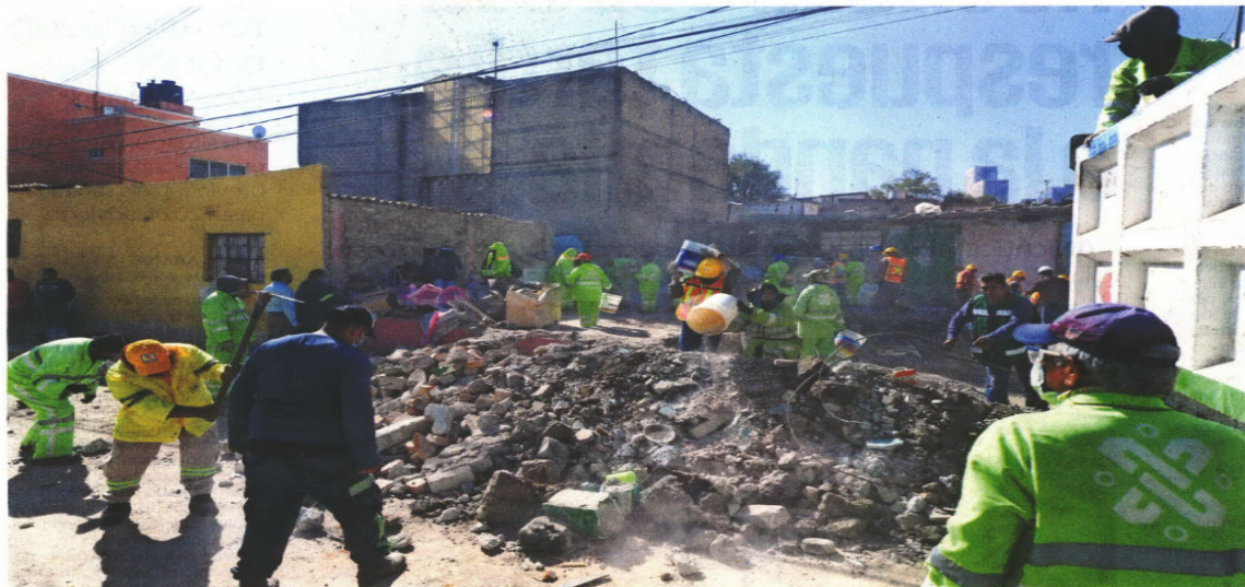
A cuatro días de la explosión de gas LP en una vecindad en la colonia Pensil, en la alcaldía de Miguel Hidalgo, donde murieron dos personas, ayer martes continuaron los trabajos de retiro de los escombros a cargo de la Secretaría de Obras y Servicios.
