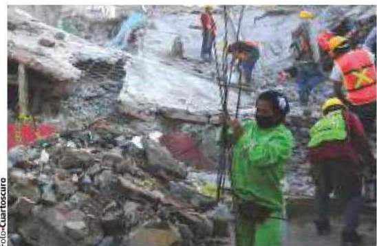
HASTA ESTE DOMINGO continuaba la remoción de escombros en la zona del siniestro en la alcaldía Miguel Hidalgo.
