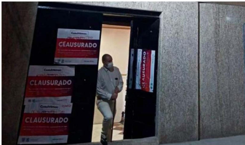
El aliado caro de Morena, el Partido del Trabajo, construía sobre avenida Cuauhtémoc para enojo de los vecinos de La Romita, acabó finalmente en clausura efectuada por un gobierno opositor.
