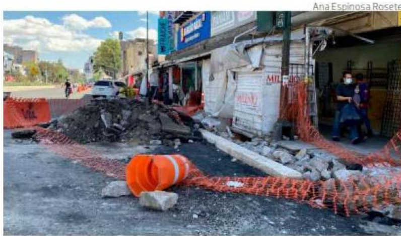
Escombros, basura y vialidad casi cerrada en Avenida San Cosme.
