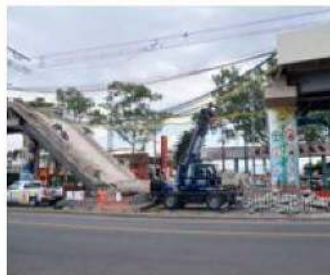
Colapso de la Línea Dorada.
