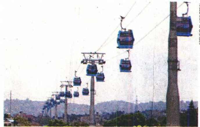
La Línea 1 del Cablebús tiene un sistema de monitoreo del cable las 24 horas del día, destacó la empresa operadora Doppelmayr.
