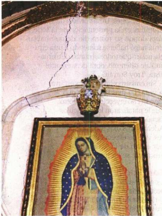
Este inmueble, que aún presenta cuarteaduras, se encuentra en estudio. Su restauración se realizará gracias al Fideicomiso del Centro Histórico.
