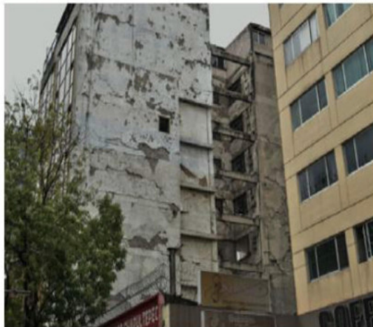
El edificio ubicado en Av. Chapultepec con el número 484 dañado en el sismo del 19 de septiembre de 2017.
