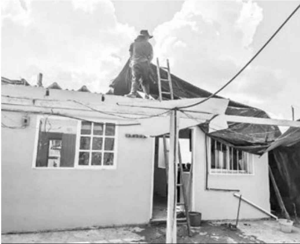
▲ Una de las viviendas del municipio de Castillo de Teayo, Veracruz, afectada por las torrenciales lluvias que hace un mes dejó el huracán Grace , el cual afectó 28 localidades de la entidad. Foto Eirinet Gómez
