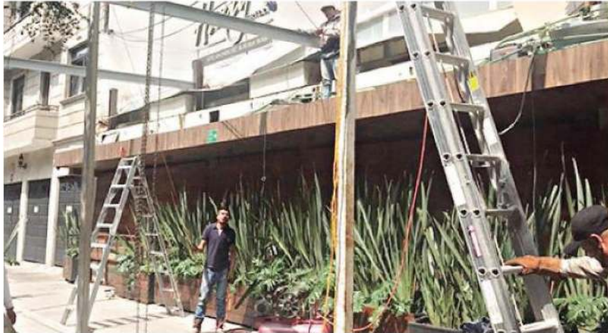
- Construyen ilegalmente en las calles y cierran pasos peatonales
