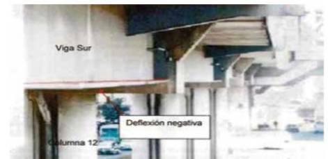
El informe final entregado el lunes pasado por DNV muestra que en diciembre de 2019 ya había deformación de las vigas.
