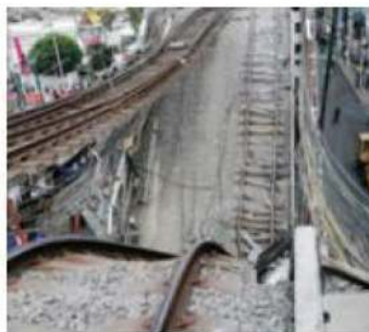
Estaban mal soldados.
