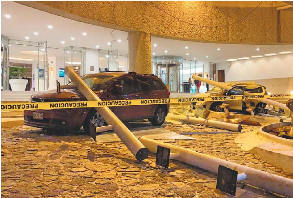
En Acapulco, varias columnas afuera del hotel Emporio se desplomaron sobre vehículos
