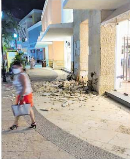
Hubo daños en comercios de Acapulco
