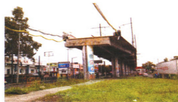
La defensa de Horcasitas tiene documentados 20 incidentes desde que entró en operaciones la L12.
