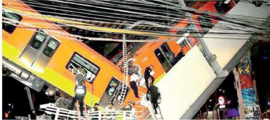
Múltiples fallas en la construcción
