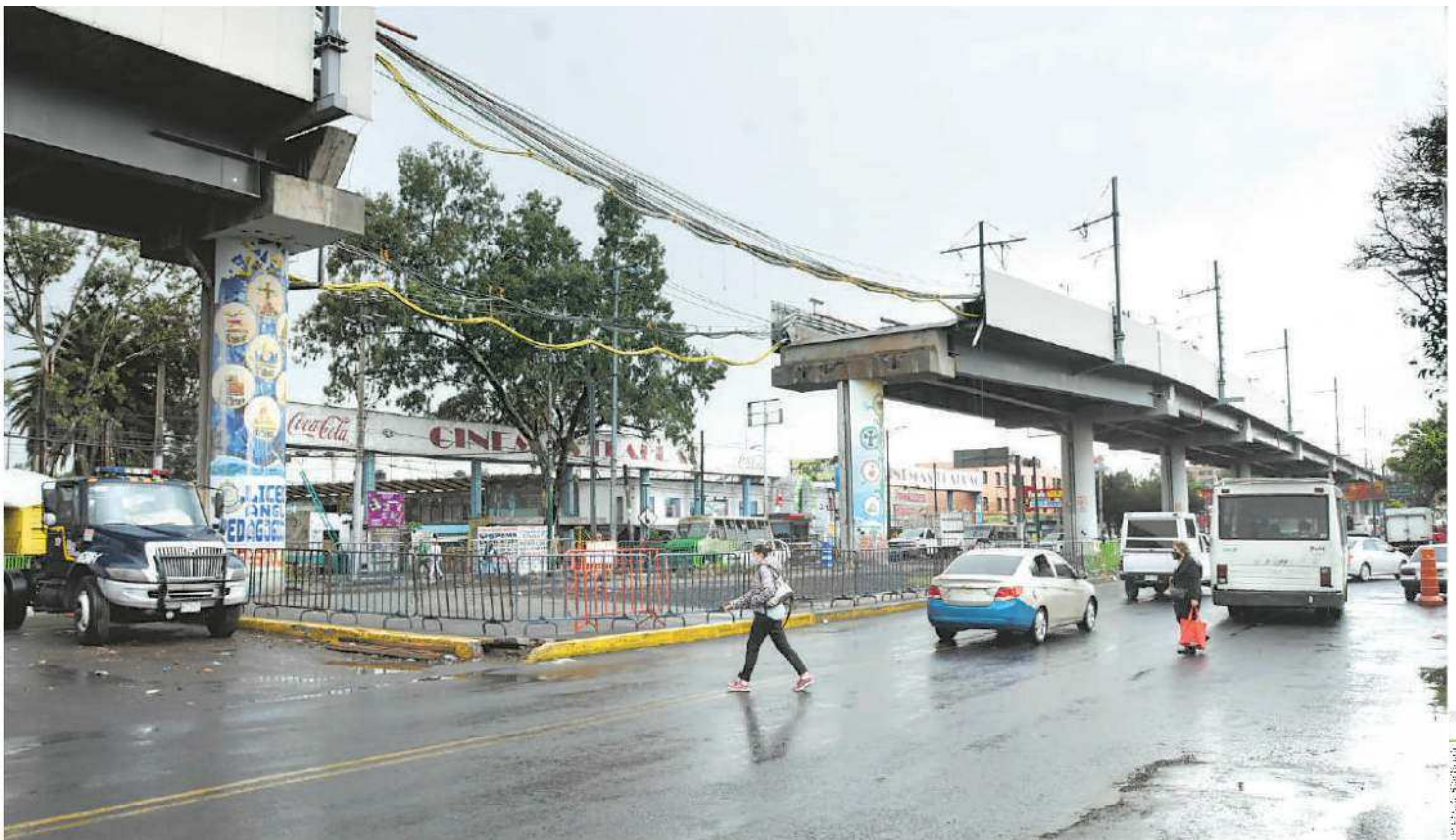
El comité recomendó la inspección aleatoria y la reparación de soldaduras de las trabes –que fueron deficientes– en el tramo elevado
