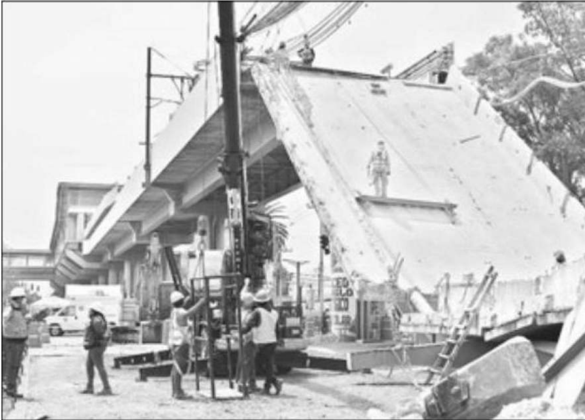
▲ Aspecto de los trabajos de remoción de escombros tras el colapso de una trabe y un vagón, la noche del 3 de mayo, en la interestación Olivos-Tezonco de la línea 12 del Metro, donde perecieron 26 personas y al menos un centenar resultaron lesionadas. Foto Luis Castillo
