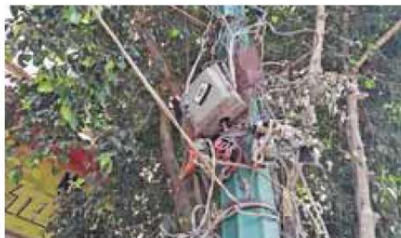
Illegal CFE reporta robo de los 36 mil 594 gigawatts. / N. CORTE
