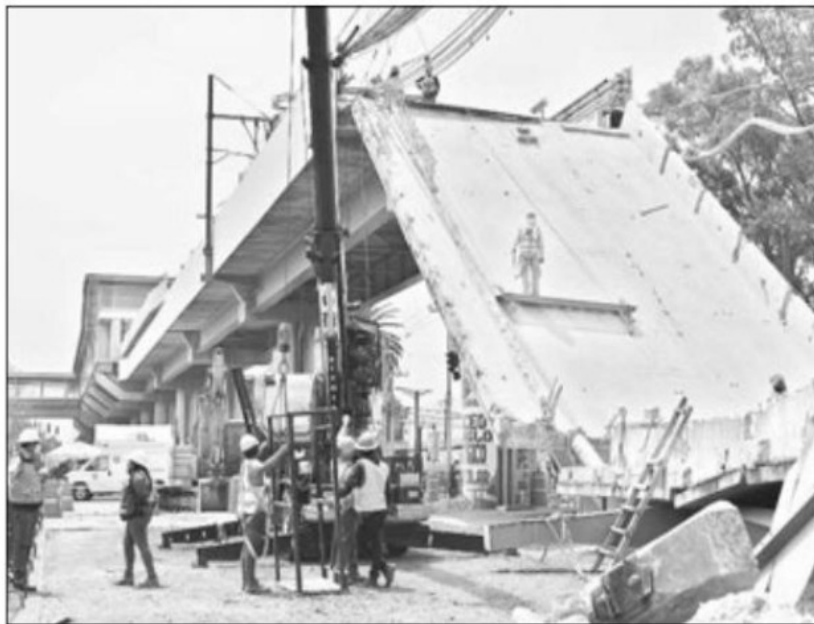
▲ Aspecto de los trabajos de remoción de escombros tras el colapso de una trabe y un vagón, la noche del 3 de mayo, en la interestación Olivos-
