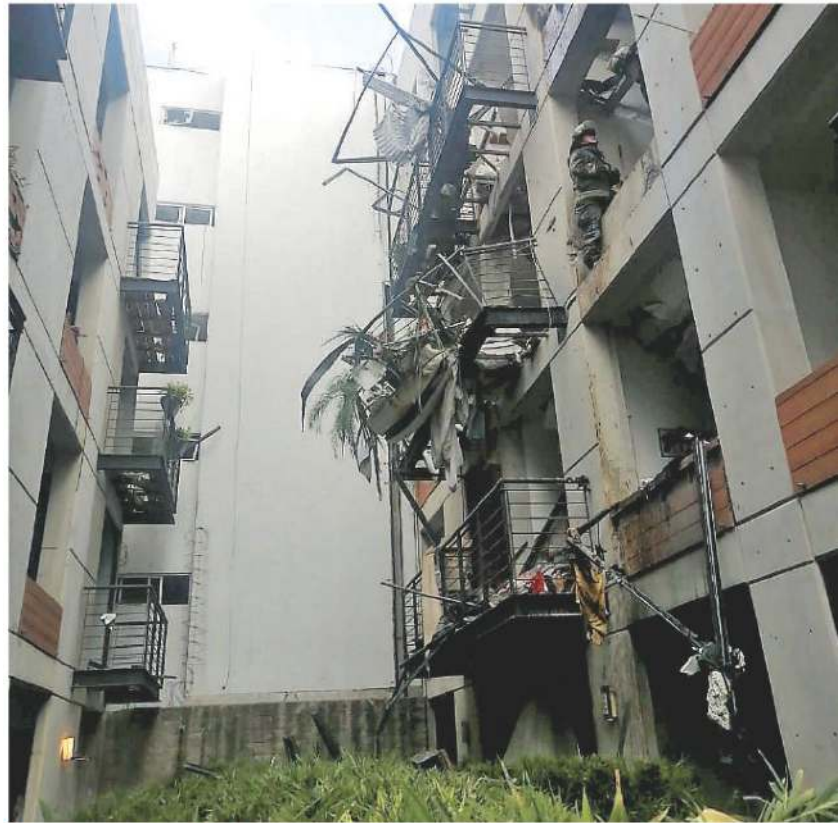
Estructura del edificio que colapsó a causa de la explosión ayer en la alcaldía Benito Juárez. Especial
