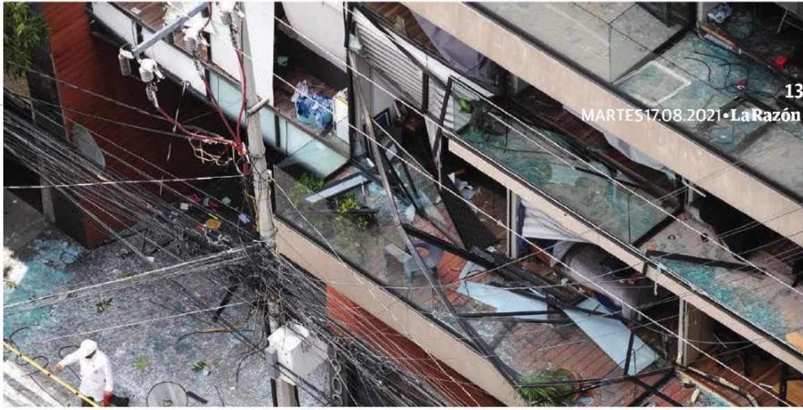
EL ACCIDENTE provocó la ruptura de cristales y el desprendimiento de barandales, y, dentro, decenas de paredes y pisos colapsados.
