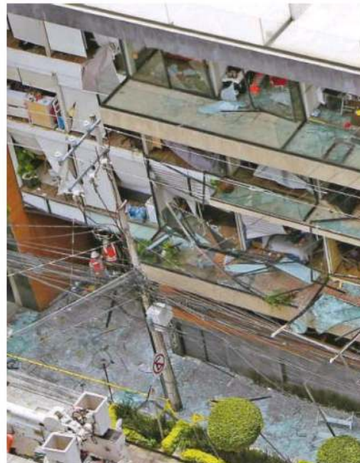
Explosión de gas LP en un edificio compuesto por 63 departamentos deja un muerto y 29 lesionados
