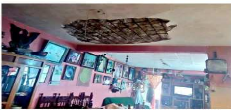
Vecinos reportan grietas y desprendimientos en sus casas.
